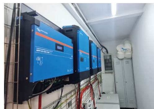
Notstrom-Batteriespeicher garantieren selbst bei längerem Stromausfall einen einwandfreien Weiterbetrieb.
