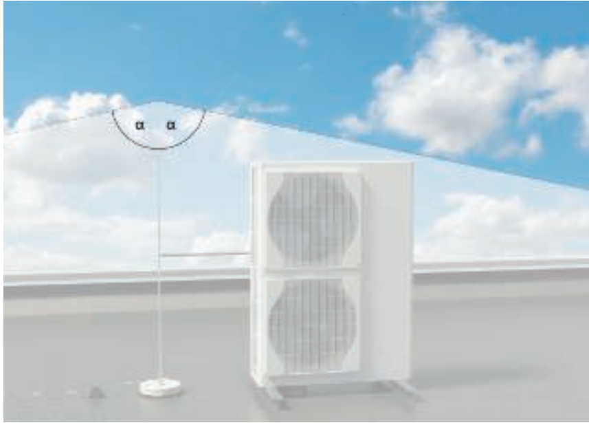
Klimaanlage im Schutzwinkel, \alpha = Schutzwinkel
