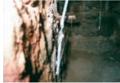
Fehlerhafte Installation Korrodierter Aluminiumleiter durch offene Verlegung auf der Wand
